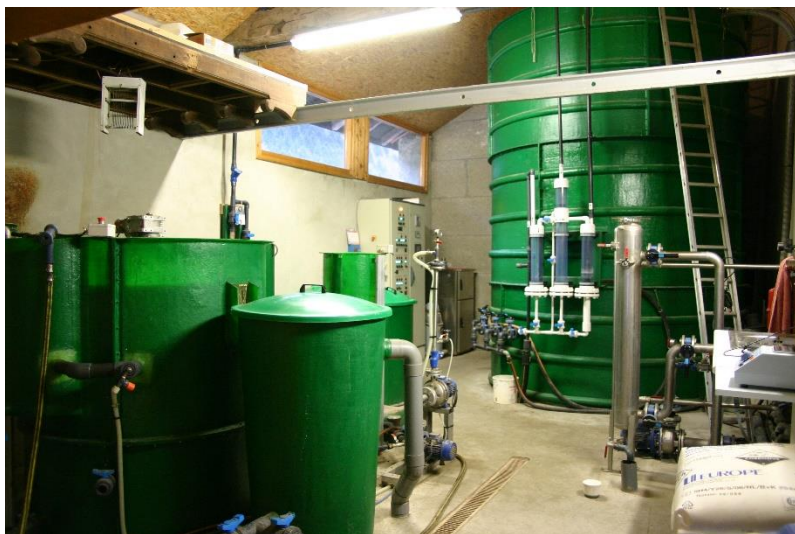
Station de méthanisation
