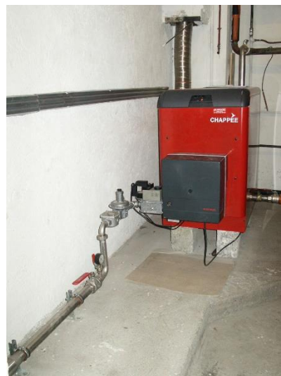
Chaudière au gaz
